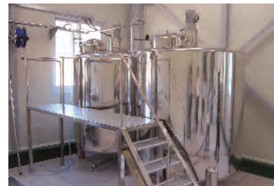
그림 3-48 이중재킷의 냉각장치와 교반기가 설치된 밀폐식 제성탱크
