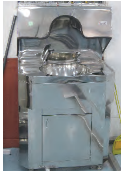
그림 3-32 출입구에 설치한 손 세척기
